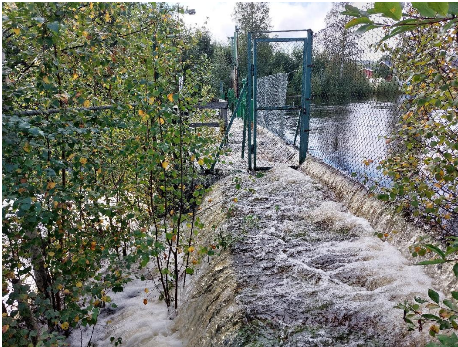
Överströmning av dammkrönet på dammen i Utansjö, 250908 kl 1200. Foto: Länsstyrelsen Västernorrland
