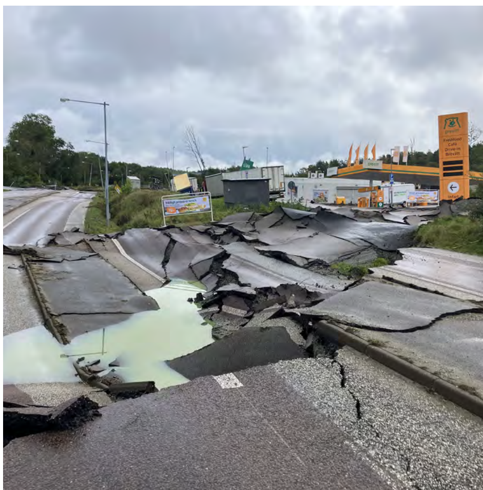
Stora delar av vägbanan på E6:an i höjd med Stenungsundsmotet rasade på grund av skredet. Foto: Jonas Axelsson, Trafikverket.
