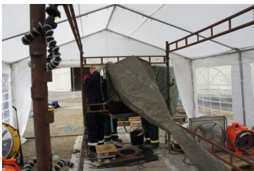
Figur 12. Fullskalig impakteringsstrut för dämpning av utsläpp.
