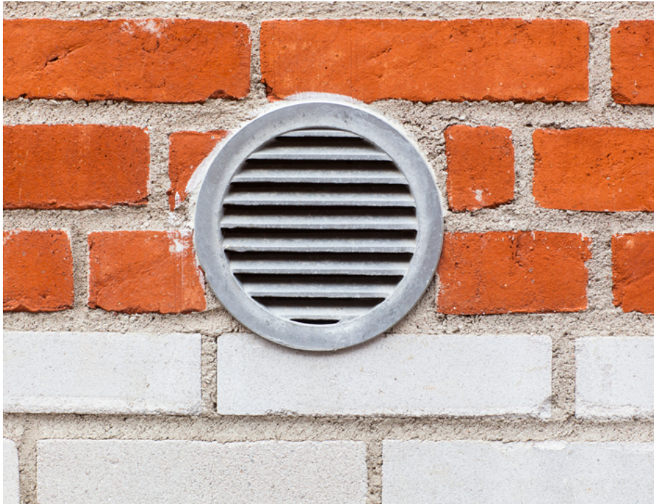
Exempel på ventilationsöppning. Foto: Johnér bildbyrå/Anna Dillner.
