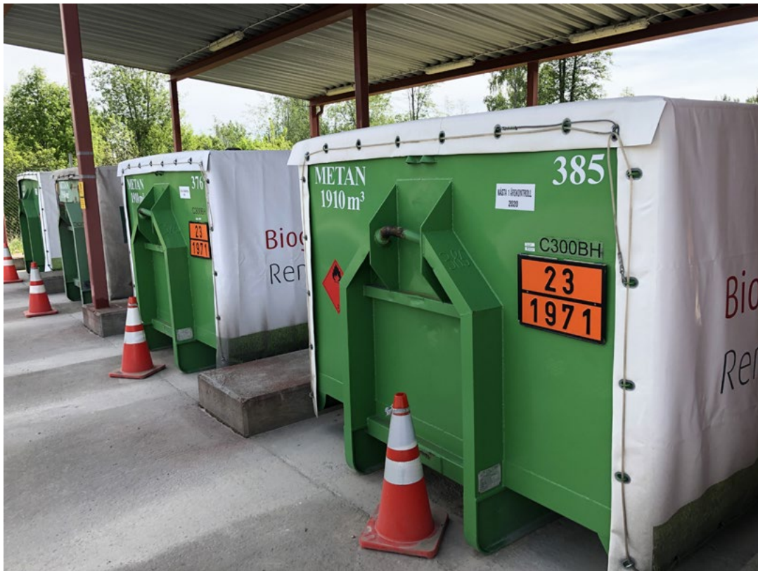
Figur 29. Mobila gaslager (MEG-containerer). Foto: David Gårsjö.
