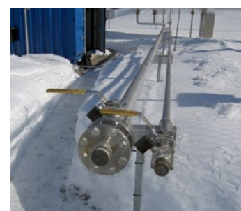
Figur 34. Exempel på rörledning med öppen ände. Foto: MSB.
