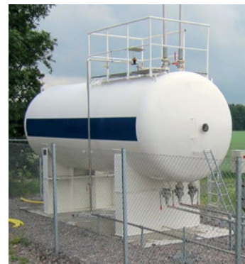
Figur 30. Exempel på gascistern. Källa: Energigas Sverige.
