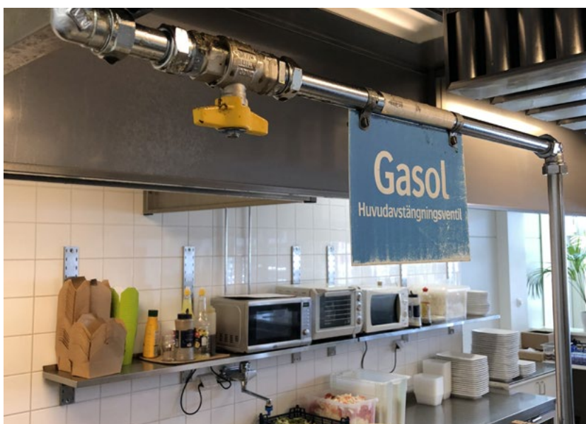
Figur 5. Huvudavstängningsventil i restaurangkök. Foto: David Gårsjö.
