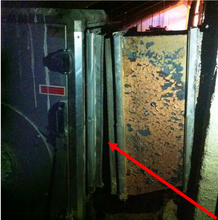
Bild 6 Övergången mellan fläkt och murstensstock där dukstosen har suttit
