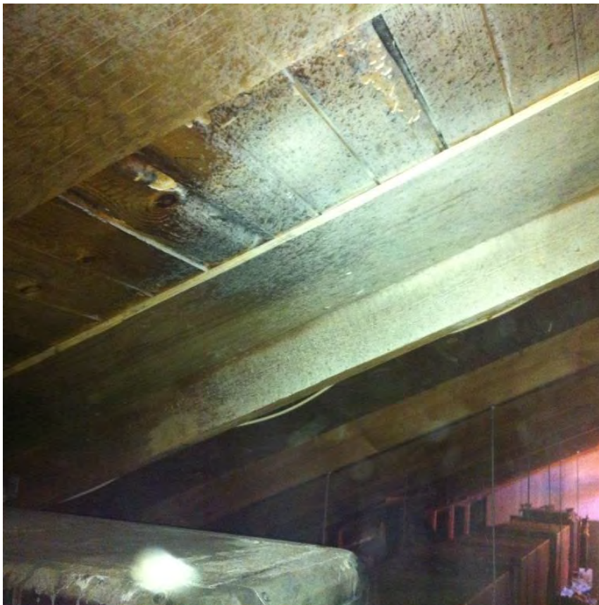
Bild 5 Pyrolysen i taket ovanför fläkten. Det vita är rester av pulversläckningen
