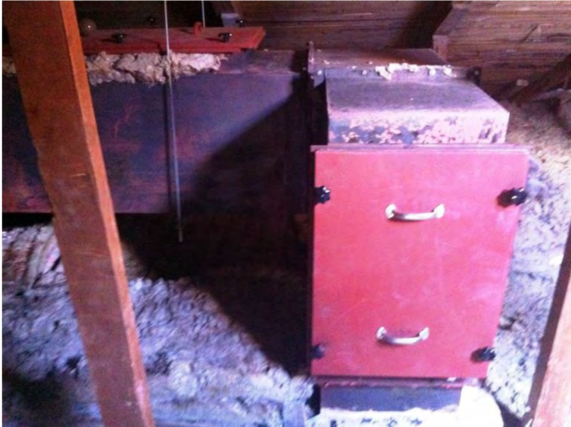
Bild 8 Renslucka där imkanalen kommer upp från stigaren
