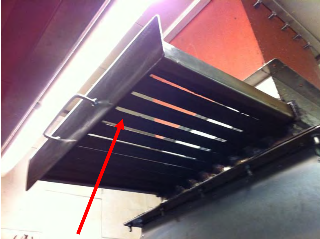
Bild 2. Gnistraster ovanför kolgrillen. Kan bytas mot en heltäckande plåt för minskad syretillförsel vid brand i imkanalen
