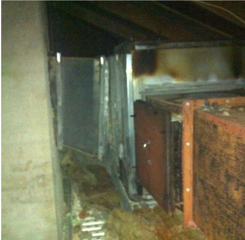
Bild 4 Fläkt på vinden mellan svartplåtskanal och murstensstock
