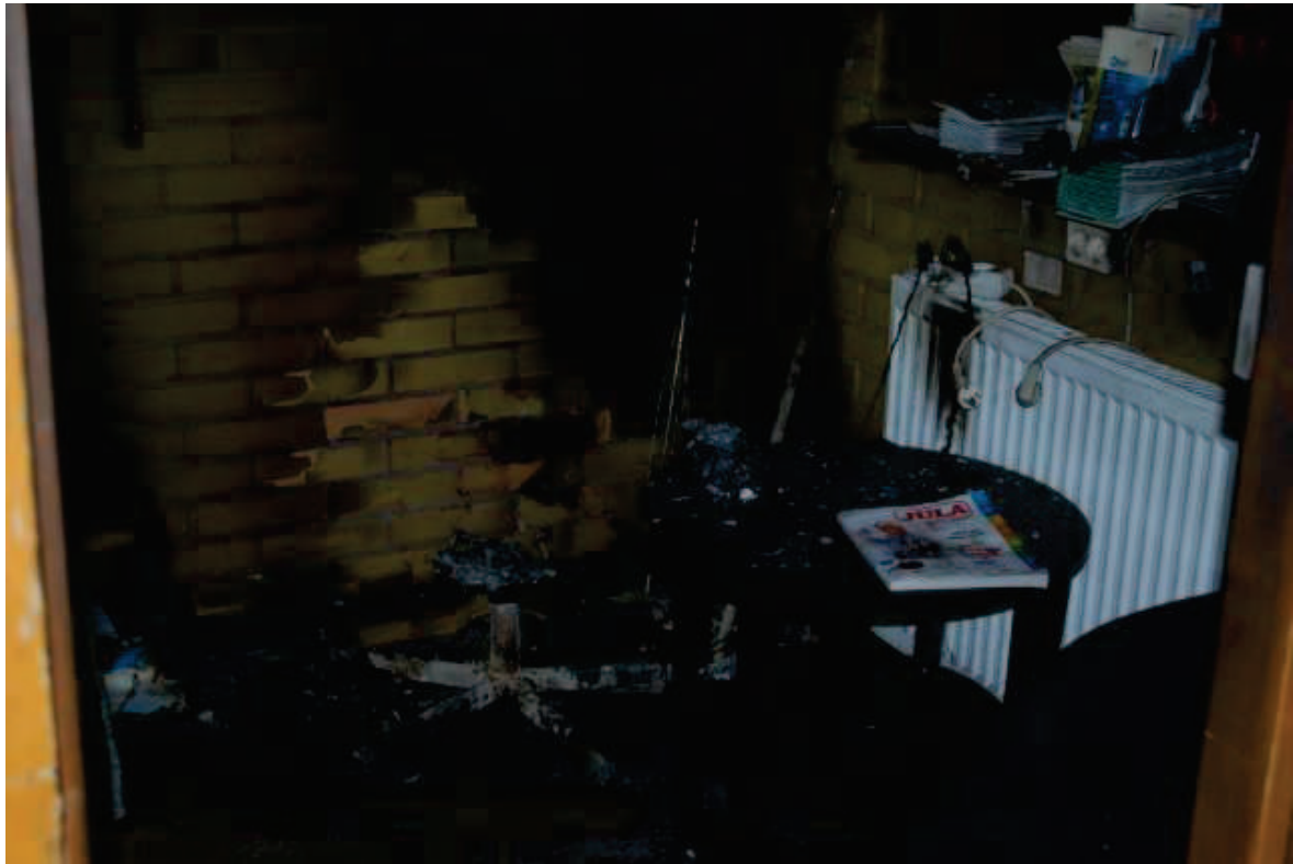
Brandskadade bordet och fätöljen
