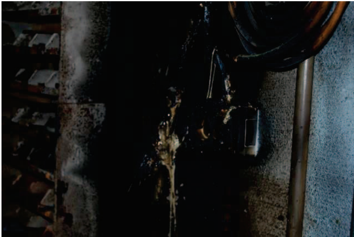
Eluttaget ovanför batteriladdaren.
