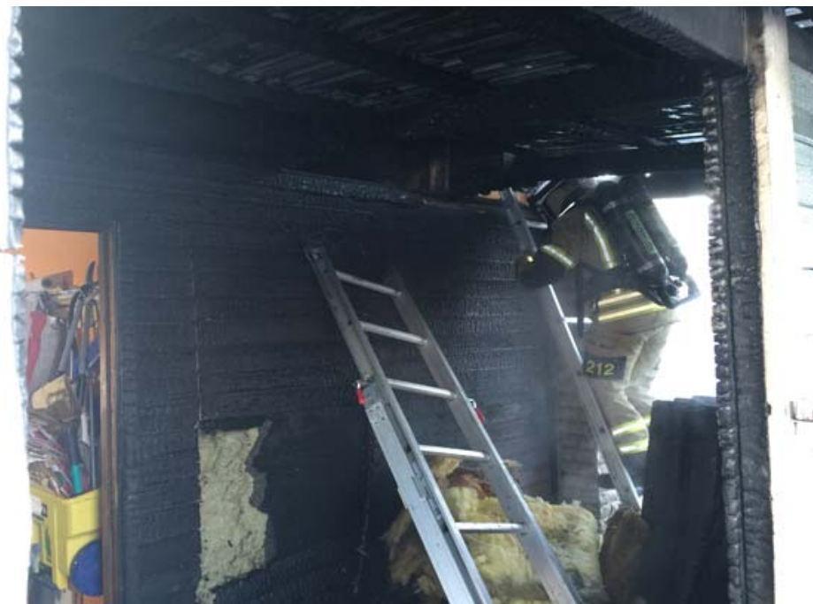
Bild 2. Branden har spridit sig via takfoten inne i skjulet.
