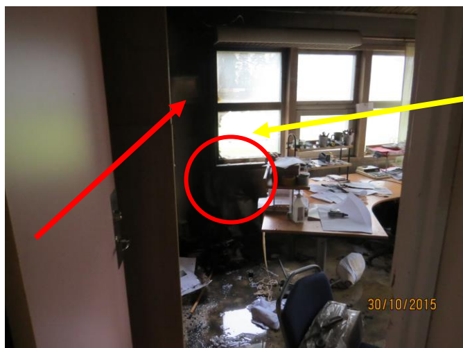
Bild 2. Bild på kansliet, den gula pilen visar det trasiga fönstret. Röda pilen visar brandskador efter att gardinen brunnit. Röda ringen visar det primära brandstartsområdet
