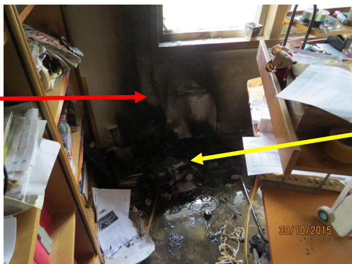
Bild 3. Röda pilen visar var de kraftigaste brandskadorna uppstod. Gula pilen visar rester av gardinen, papper och smält plast.
