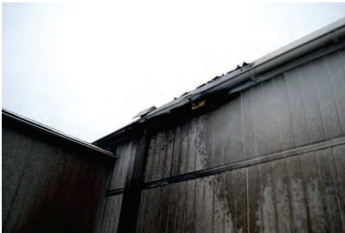
4. Brandskador i takfot
