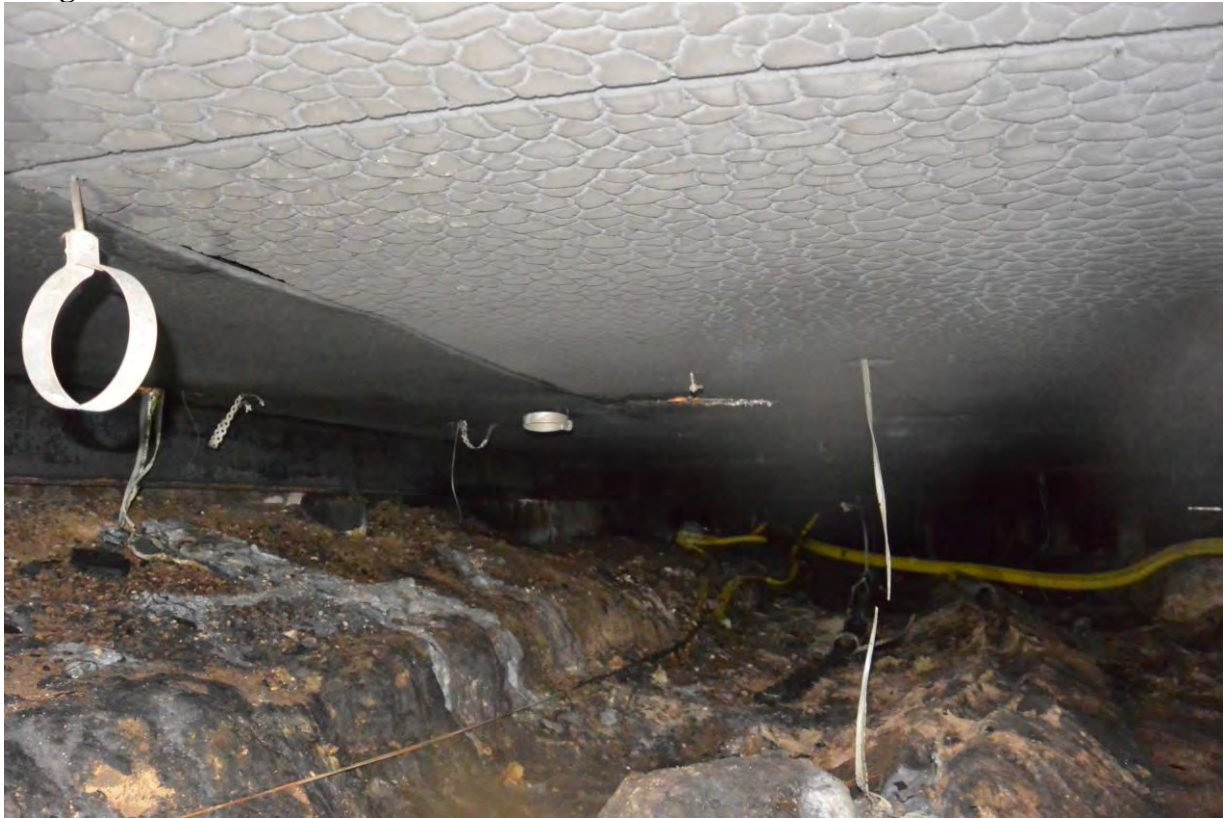
Figur 3. Golvbjälklag sett från krypgrund. Tydligt värmepåverkade gipsskivor.
