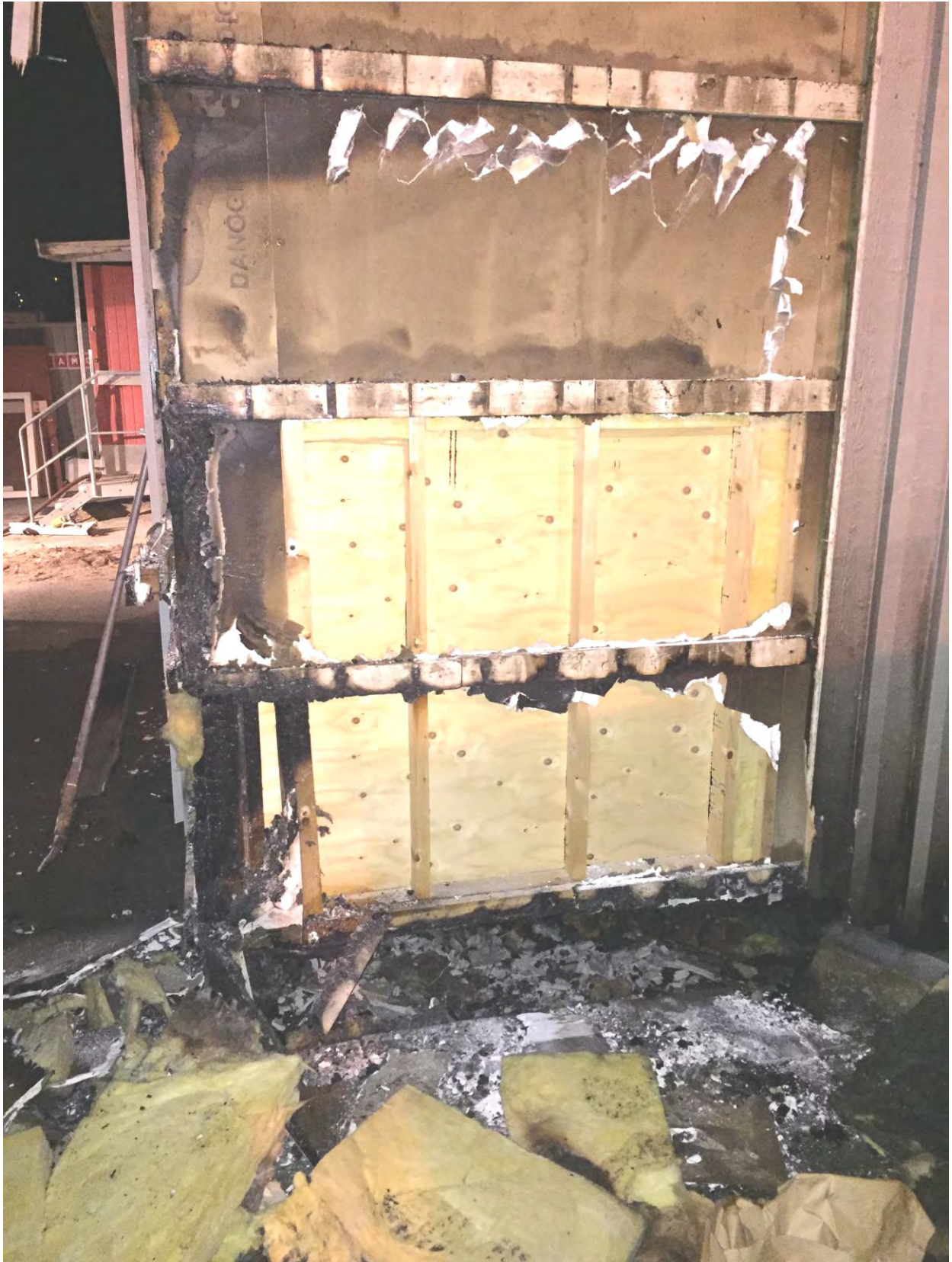
Figur 5. Avskalad yttervägg, sydvästra hörnet av byggnaden
