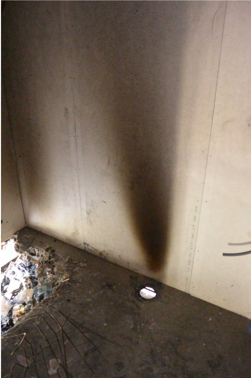
Figur 6. Brandskador på gipsvägg.
