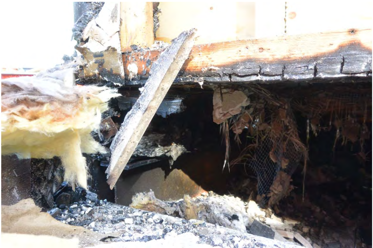
Figur 4. Avskalad yttervägg med bränd syll synlig
