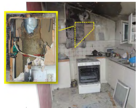
Bild 8. Översiktsbild över köket innan väggen till imkanalen revs. Bilden med gul markering visar hur det såg ut bakom. Foto: RSG
