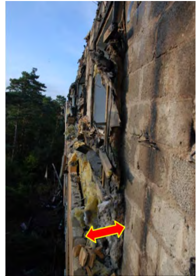
Bild 4. Pilen markerar mellanrummet mellan teglet och betongstenen. Källa: RSG
