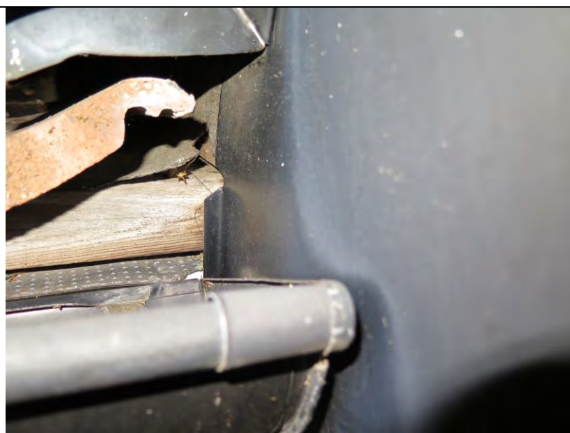
Figur 17 , ytterligare en bild som visar att läkten går igenom in till hålutrymmet mellan gipsväggarna. Metallen i förgrunden består av stupröret.
