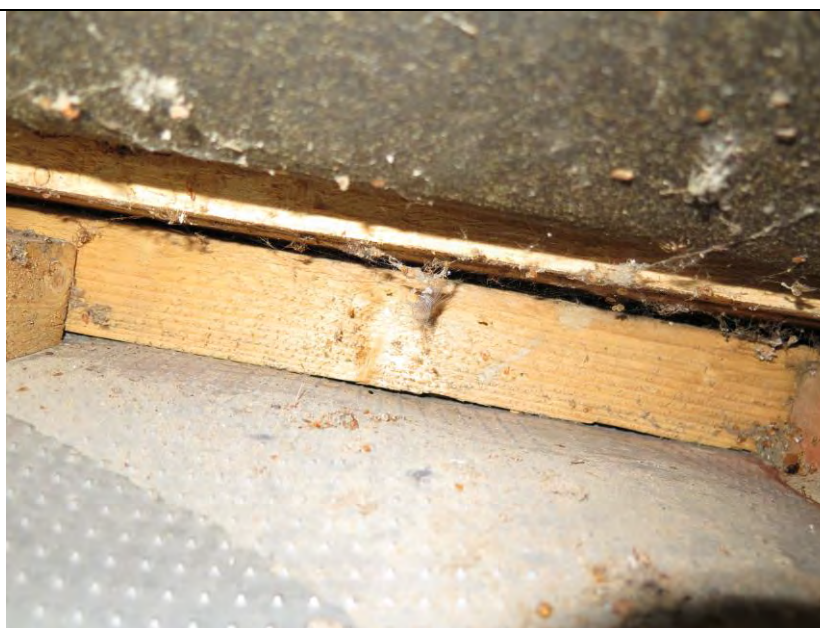
Figur 15 , visar där läkten ansluter till reglarna. Här finns tydliga håligheter som leder till ett hålutrymme mellan de bägge gipsväggarna mellan husen.
