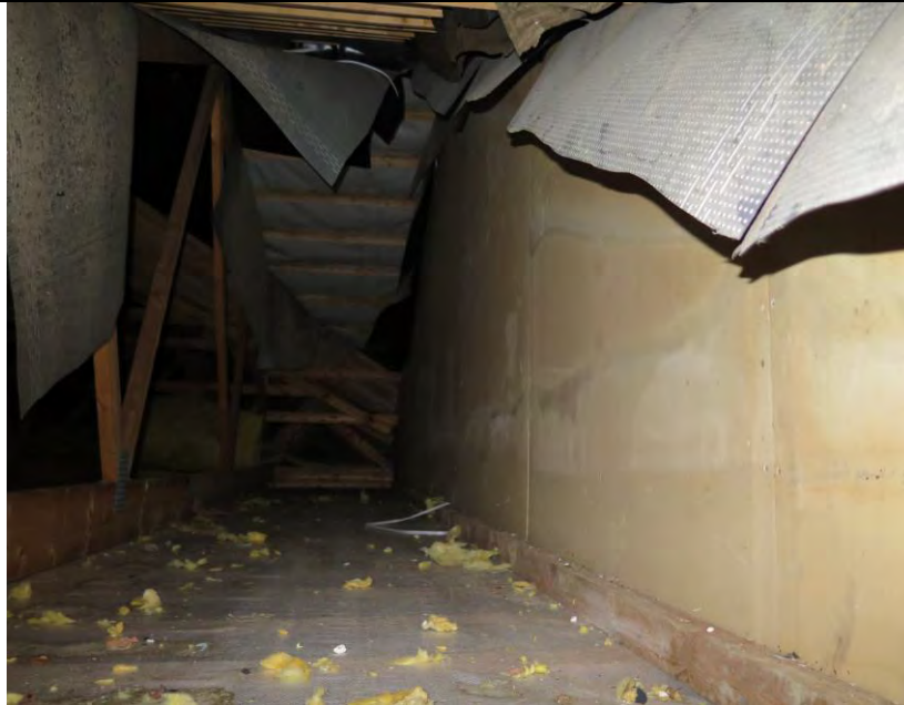
Figur 12 , visar vinden på det tredje huset som klarade sig från branden. Mot höger till det andra huset sitter en gipsskiva. Mattorna som hänger ner på bilden är fuktspärren som suttit uppspänd mot läkten. Takstolarna är sammanhållna med spikplåtar som kan ses till vänster i bilden där takstolen går ner i balkregeln.
