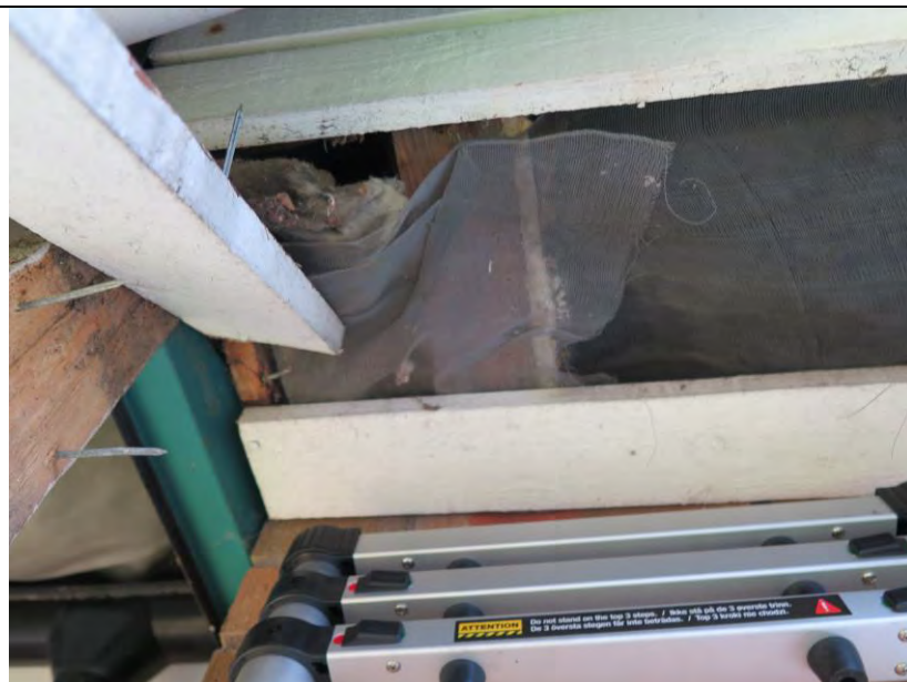
Figur 16 , visar hålutrymmet mellan gipsväggarna. Därifrån var takkonstruktionen densamma som i övrigt vilket innebär att spridning snabbt skedde genom fuktspärr och sedan förbi gipsväggen till näraliggande hus.
