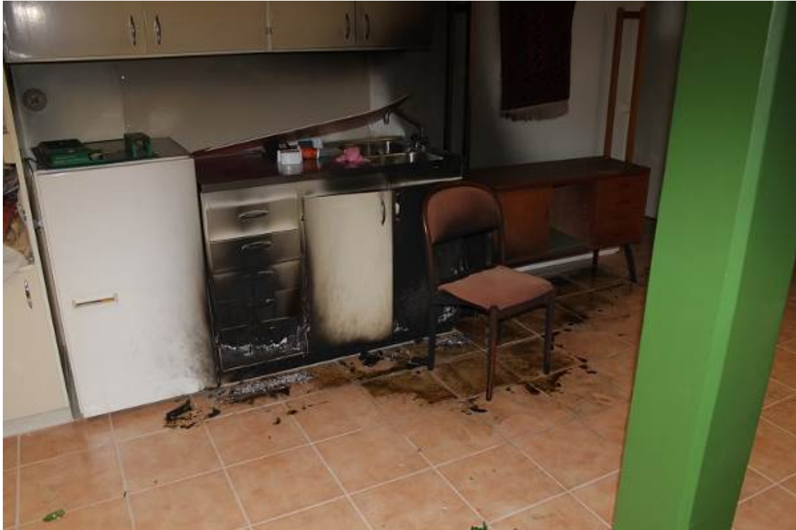
Bild . Branden har inte orkat fått tag i det brännbara material som fanns i rummet.
