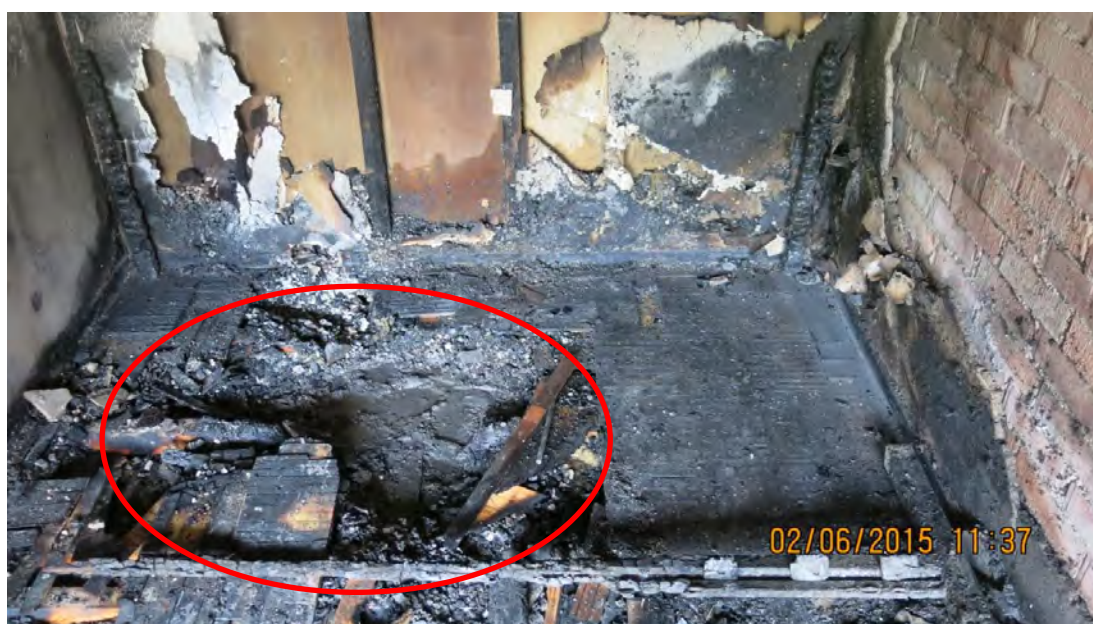
Figur 11, visar området med de lägsta brandskadorna. (Foto från försäkringsbolagets utredning)
