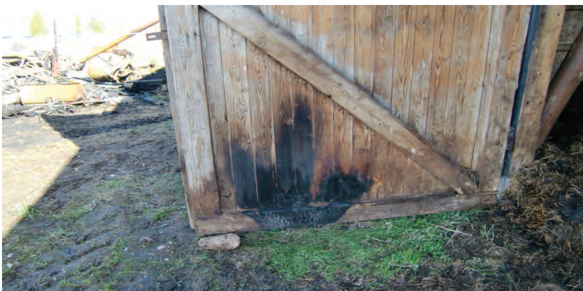
Bild 1. Insidan på ladugårdsdörren som var brandansatt.
