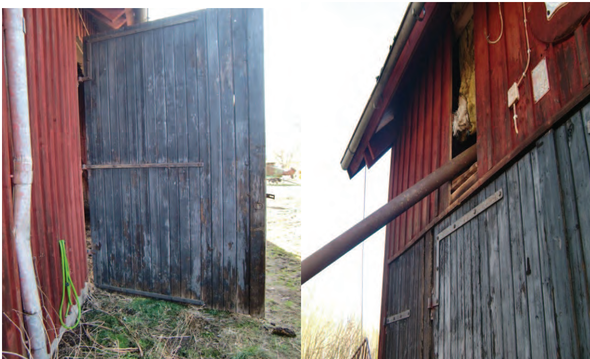
Bild 1. En branddrabbad ladugårdsdörr och öppningen till loftet som branden höll på att sprida sig till.
