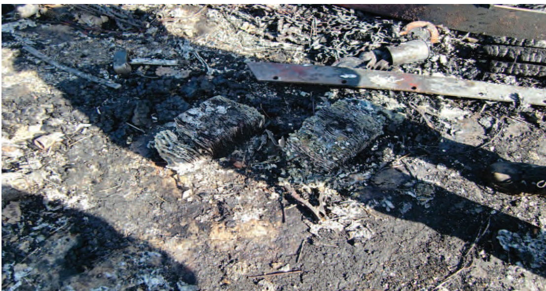
Bild 8. Batteri som laddades och som var trolig orsak till branden.
