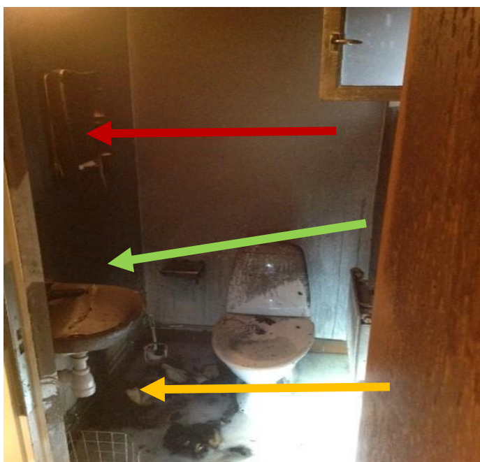
Bild: 4 röda pilen visar pappershållaren för handdukar, gröna pilen visar var hållaren för toalettpapper suttit samt gula pilen visar branden på golvet.
