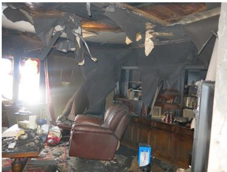
Figur 10: Brandskador i vardagsrum (YB:s foto).
