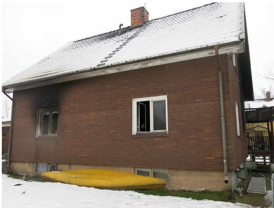
Figur 4: Husets baksida efter första branden (YB:s foto).
