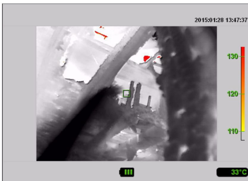
Figur 24: Bild från värmekameran tagen från ytterdörren upp mot övre plan. Bilden visar att undertaket i hallen, väggar på ovanvåningen samt taket mot vinden bortbrunna. Det mörka området som går från bildens nedre vänstra hörn in mot mitten på bilden är vatten från strålrör.
