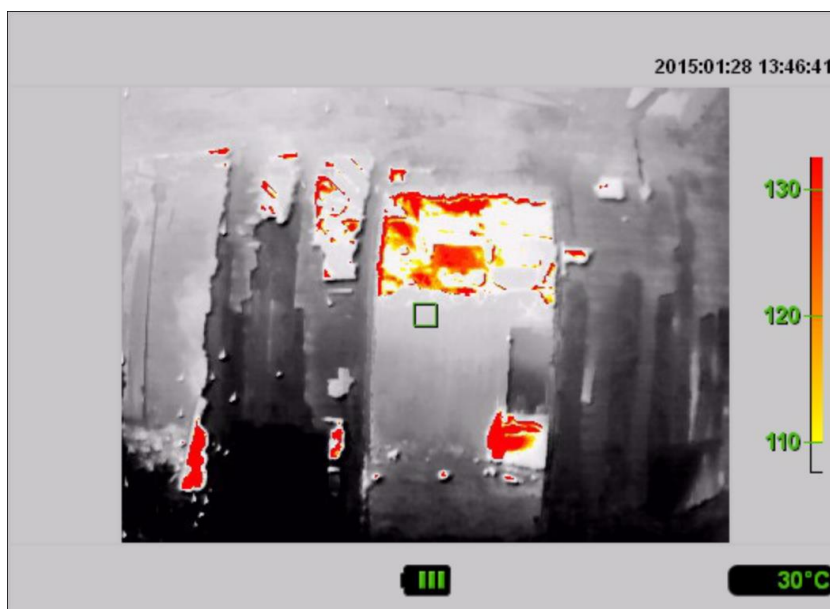
Figur 22: Bild från värmekameran tagen från ytterdörren mot vardagsrummet (kl. 12:35:59).
