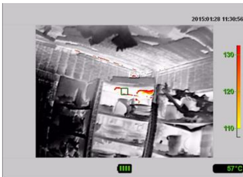
Figur 20: Hotspots i skåp samt i takets anslutning mot yttervägg (kl. 10:20:14).
