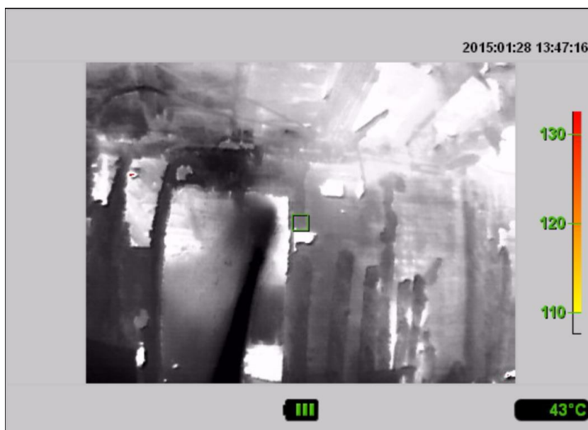
Figur 23: Bild från värmekameran tagen från ytterdörren mot vardagsrummet. Bilden visar att undertaket i hallen och innerväggen mellan hall och vardagsrum är i det närmaste bortbrunna. Det mörka området som syns i dörröppningen till vänster är vatten från strålrör.
