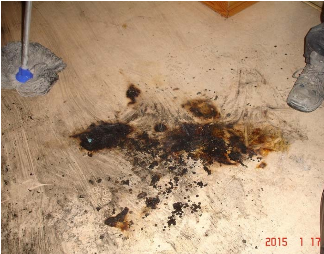
Bild 4: Brandskador i korkmatta.
