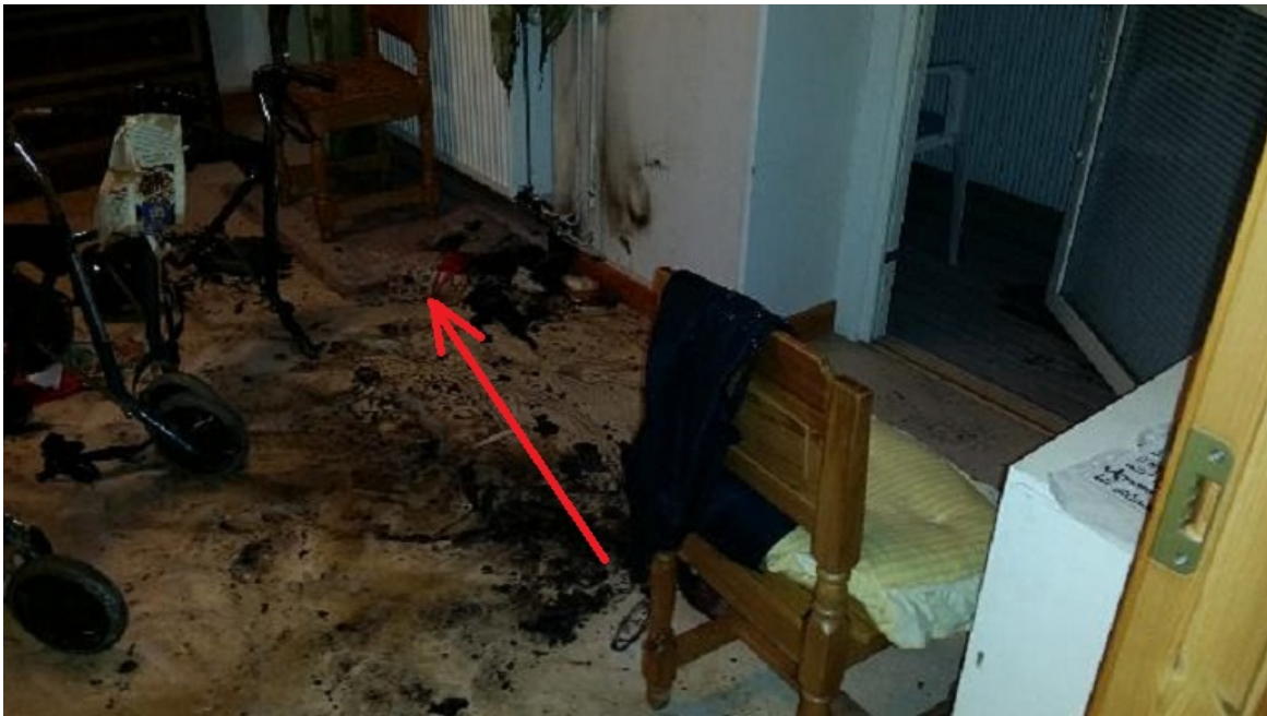
Bild 1: Vid upptäckt stod personen vid pilens början, föll sedan i pilens riktning. Hon brukade sitta på denna stol vid rökning. Till vänster i bild syns rullatorer som även dom hade brunnit i däck. Till höger syns även balkongdörren.
