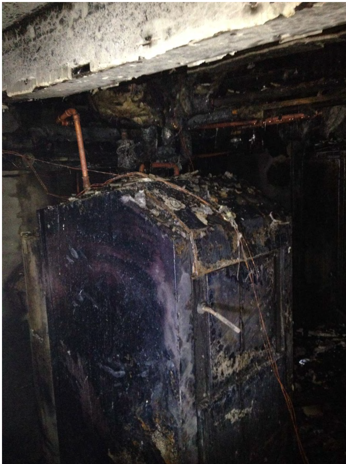
Bild 5. Värmepannan i källaren.
