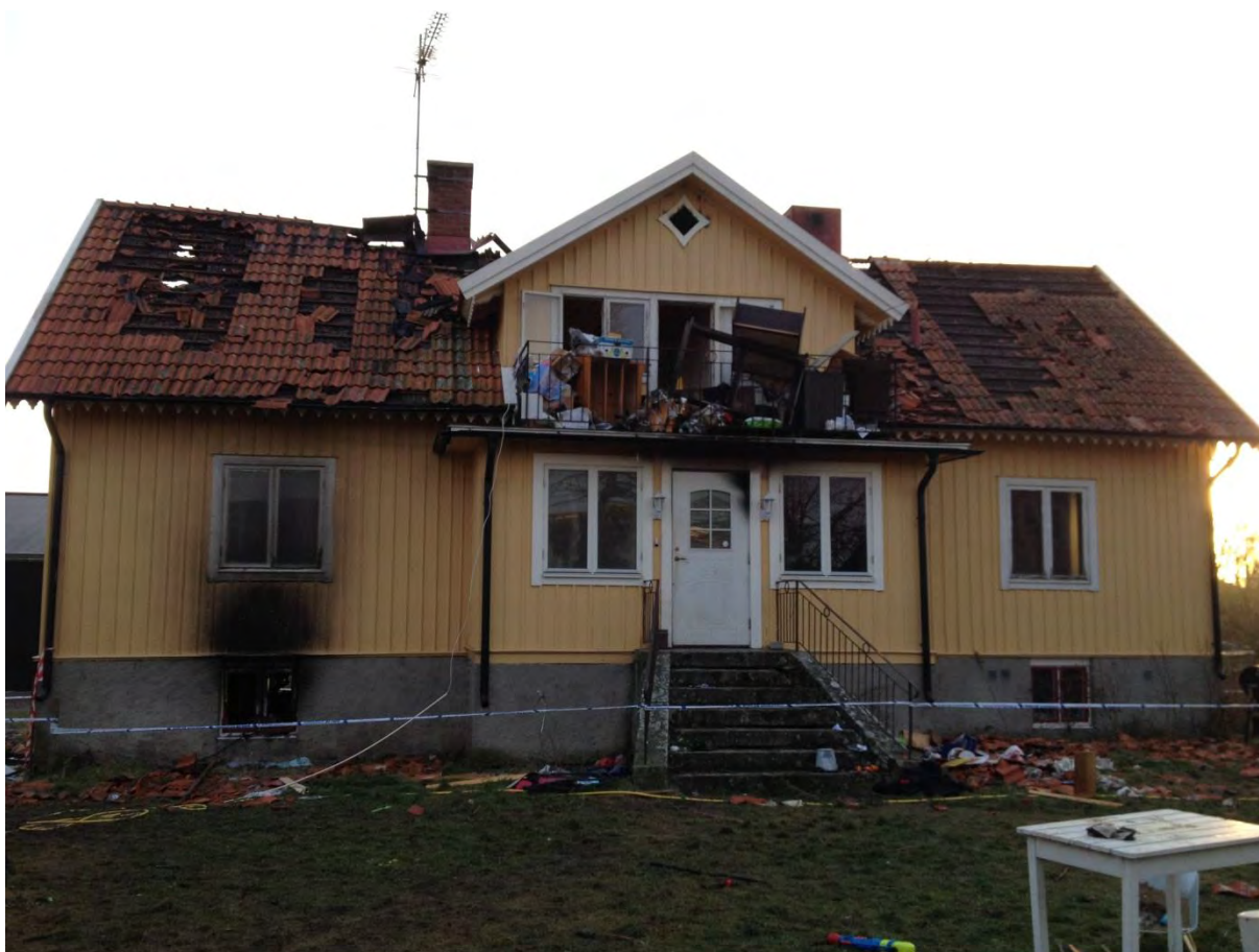
Bild 1. Byggnaden dagen efter branden.
