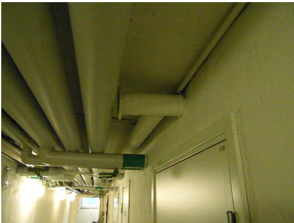
Frånluftdon i källare (mekanisk ventilation).
