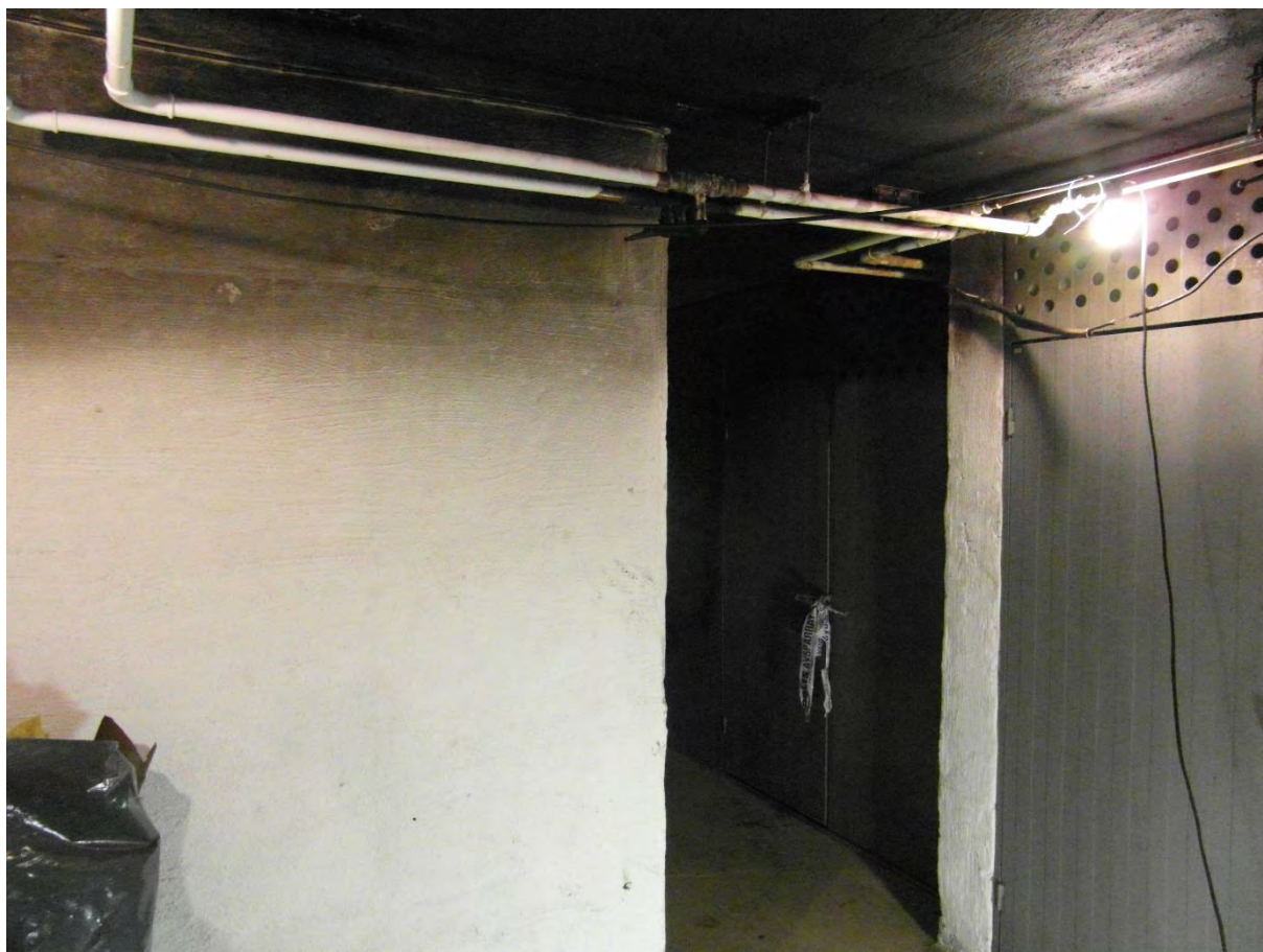
Brand- och rökskador i källare.
