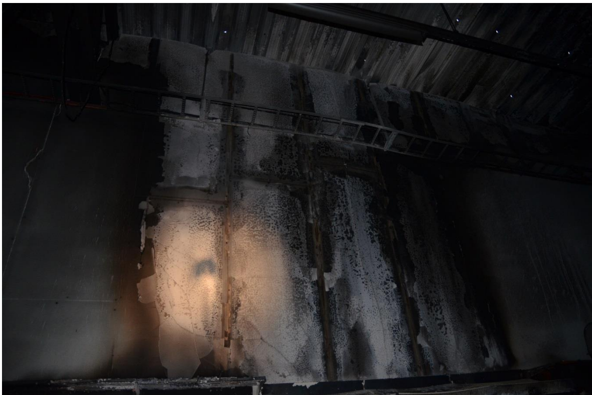
Brandskador längs brandcellsgräns, troligtvis från smält cellplast som runnit och brunnit
