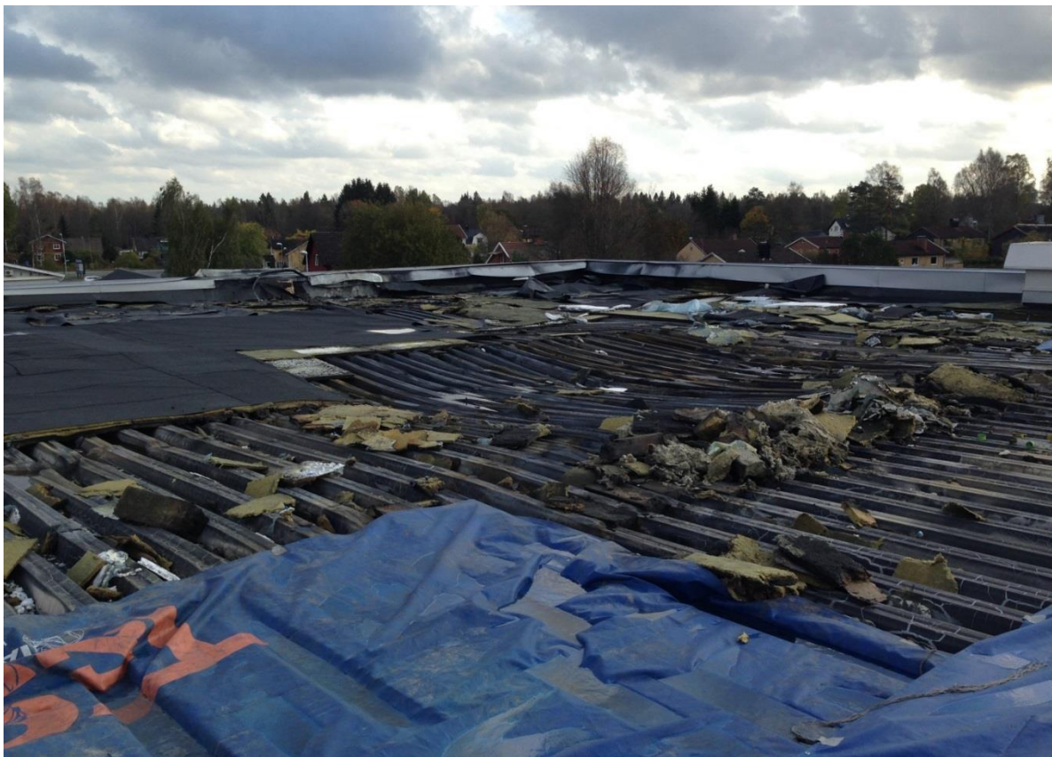
Taket med den brandpåverkade självbärande plåten. Fläckvis finns rester kvar av cellplastisoleringen.
