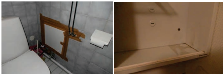
Figur 12,13 Rökspridning till lägenheten rakt ovanför på våning 3, badrummet
