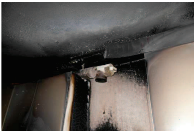
Figur 7, Frånluftsdon i köket ovanför spisen
