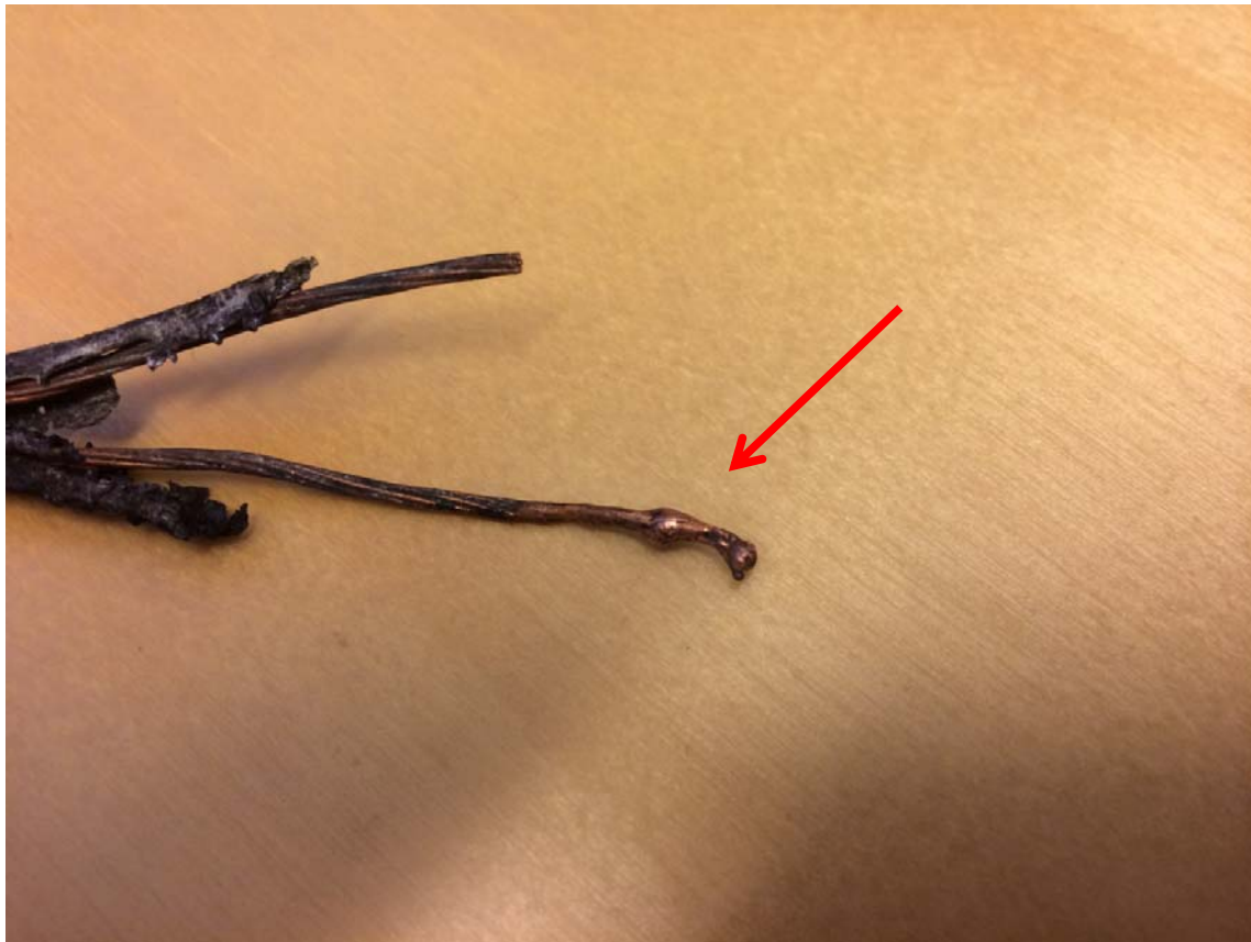
Bild 4 Primärskada på elkabel från väggen
