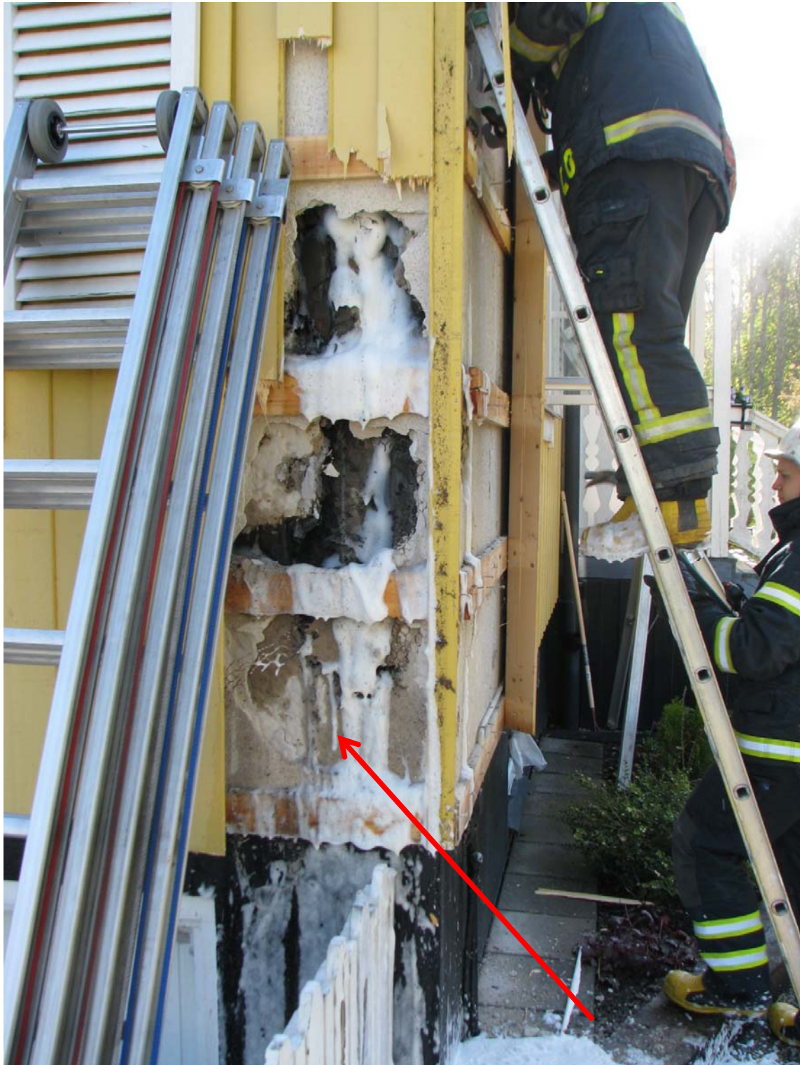
Bild 3 Del av vägg som frilades för att släcka branden som hade startat inuti väggen vid pilen
