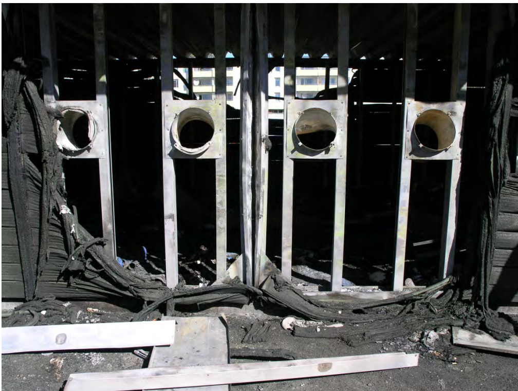
På mitten av väggen hade väggen brunnit ner till marken
