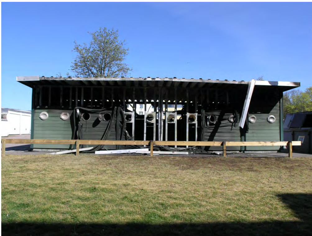
Södra sidan av återvinningshuset där det har brunnit igenom väggen
