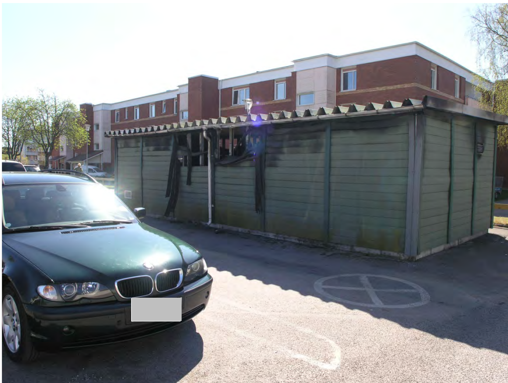
Väggen på norra sidan hade det också börjat brinna igenom, med risk för brandspridning till bilarna
