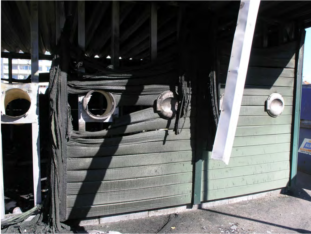
Den andra delen av väggen med smältskador
