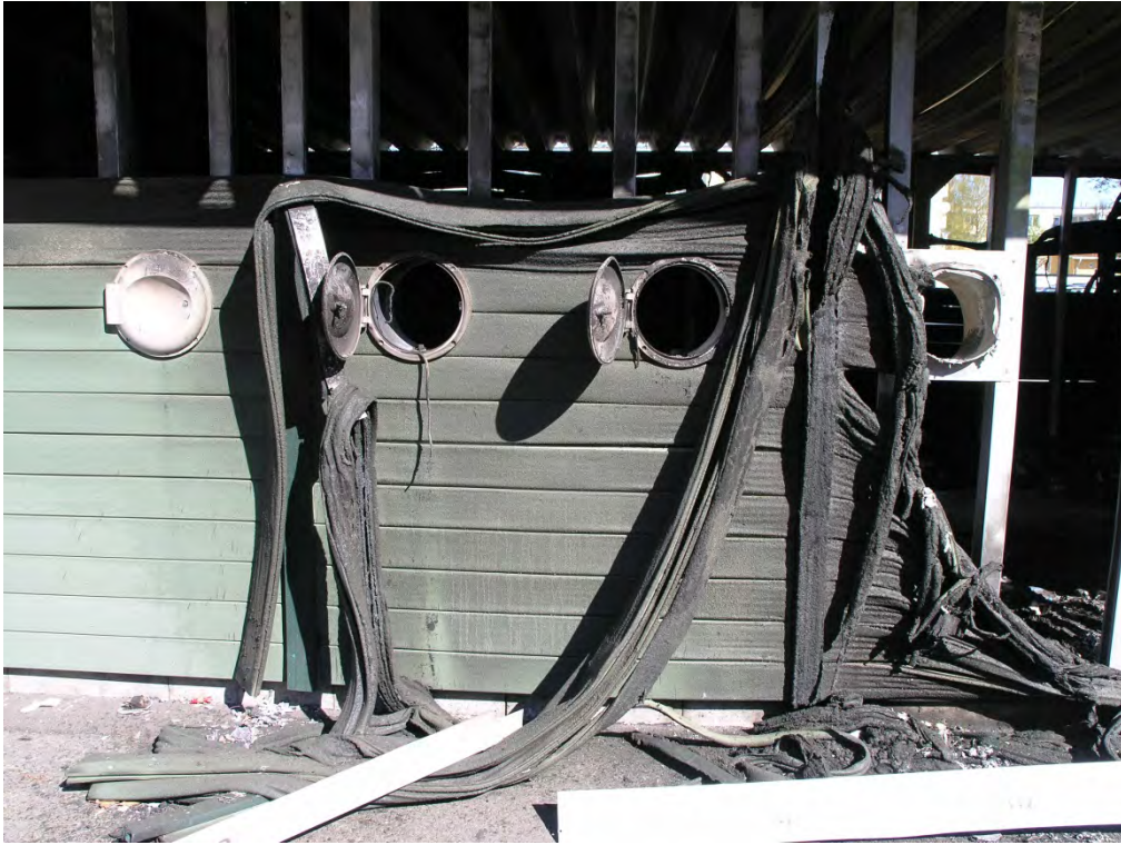
Fasaden av plast som brunnit upp eller smält
