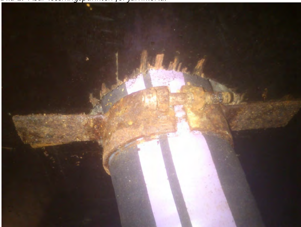
Bild 2: Visar påfyllningsslangen på insidan av cisternrummets vägg. Man kan se hur metallen är angripen av miljön i cisternrummet
