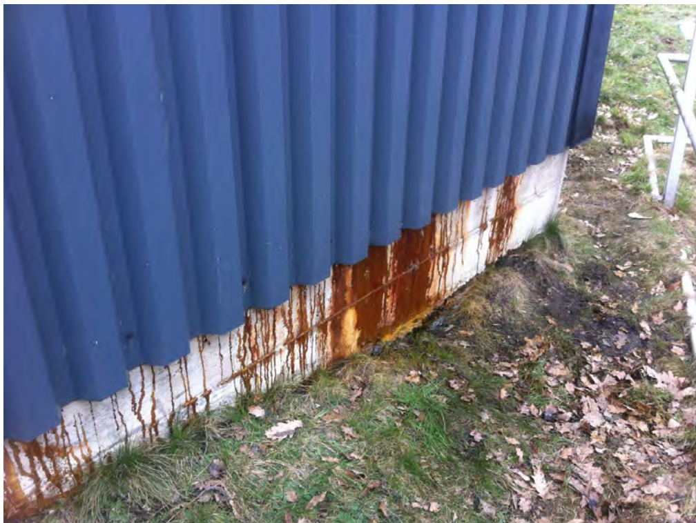
Bild 7: På denna bild ser man hur järnkloriden följt bottenplattan och läckt ut mellan densamma och väggen.
