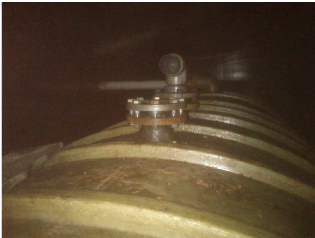
Bild 5: Här kan man se påfyllningsröret som slangen släppte ifrån och även flänslocket strax framför/under som enbart var åtdraget med en bult (bilden är tagen senare då samtliga bultar är åtdragna).
