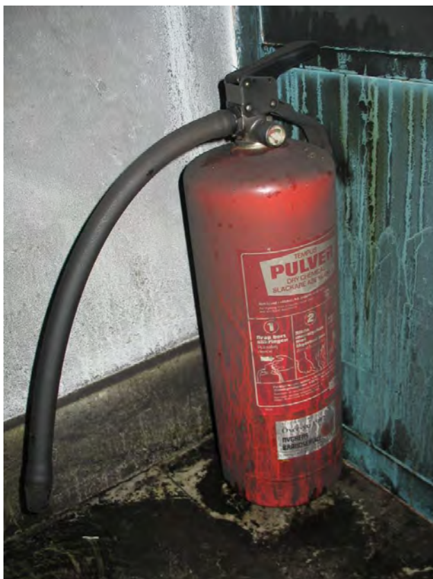
Bild 7. Handbrandsläckare i trapphuset till plan två.
