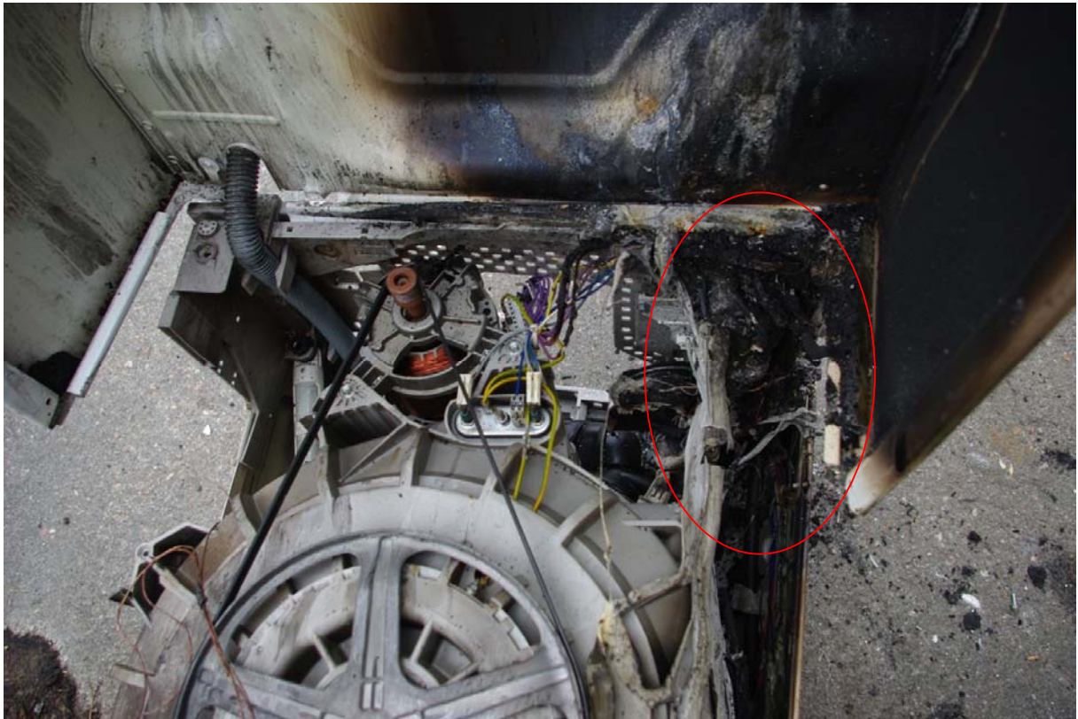
Maskinen bakre högra hörn markerat.
