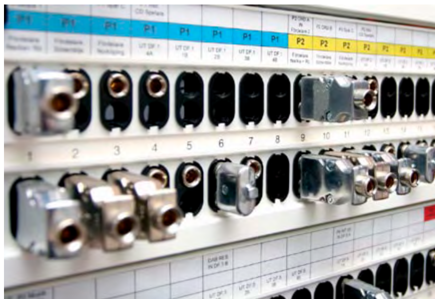
Redundans i viktiga tekniska system för Sveriges Radio.
