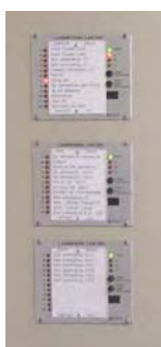
Larmpanel plac i skåp +A11.
