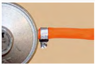
Slanganslutning vid reducerventil
