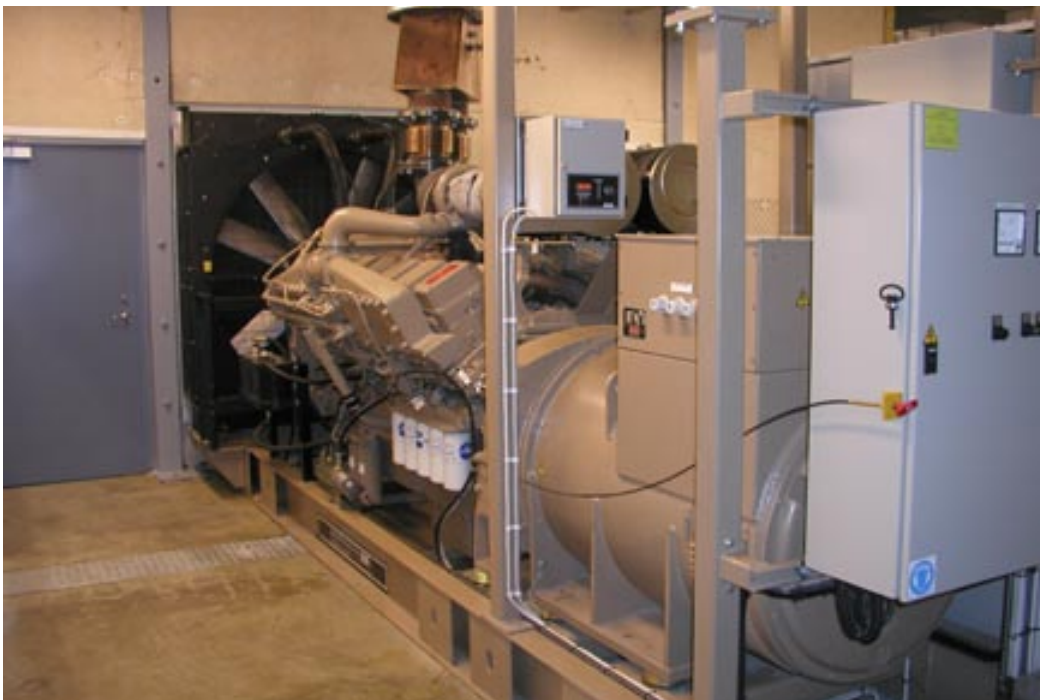
Figur 8. Reservkraftsaggregat vid Sunderby sjukhus.
