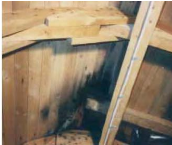
figur 9 Exempel på invändig fuktskada
