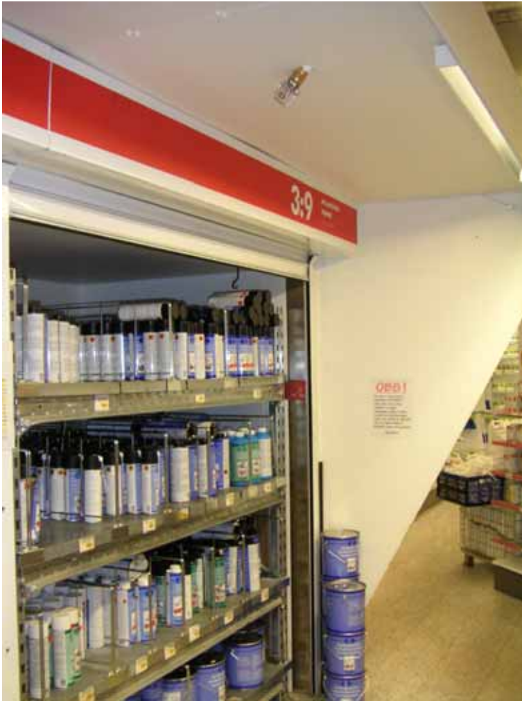
Figur 27 Alkov med jalusi samt sprinkler på Biltema i Göteborg, Backaplan.
