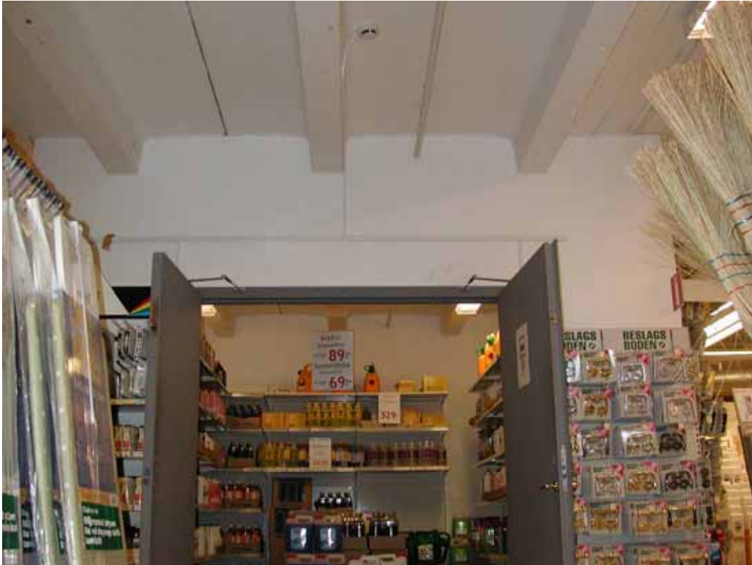
Figur 24 Avskilt utrymme för brandfarlig vara på EKO Stormarknad i Borås. Notera rökdetektorn i taket utanför rummet. Denna samt ytterligare en inne rummet stänger dörren automatisk vid detektion.
