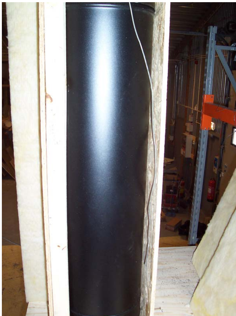
Figur 11. Bilden visar schaktet som omgav skorstenen vid Försök 2 och 3. Avståndet mellan skorsten och skiva är 50 mm..
