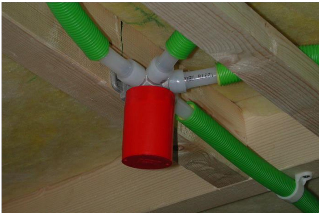
Figur 1 Varje sprinkler ansluts med fyra 16 mm PEX-rör i Uponor Wirsbo boendesprinklersystem. Fotot visar ett system som är under installation och sprinklern är därför försedd med en skyddskåpa.
