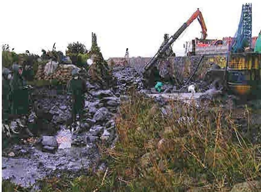
Sanering vid en pir i Camelle
