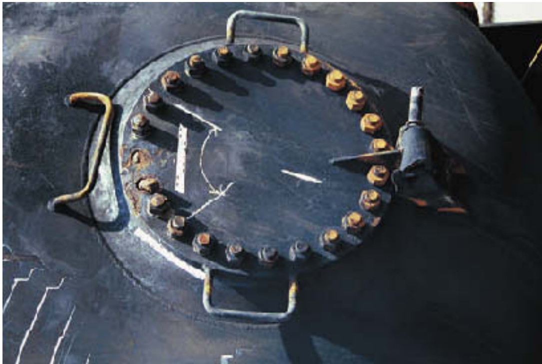
Figur 6.3 Mannlokk med ødelagte bolter Kilde: DnV
