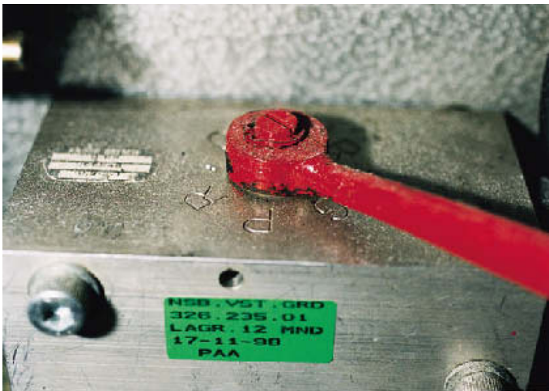
Figur 3.5 GPR-kran på lokomotiv El 16 nr. 2215 i G-stilling ved Kommisjonens og politiets inspeksjon etter ulykken Kilde: Romerike politidistrikt
