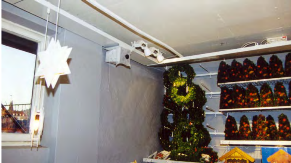
Figur 11. Videokamera monterad under en kabelränna i varuhuset i Älmhult.
