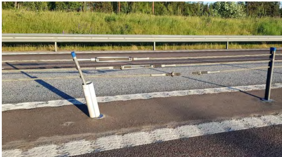
Bild 19. Stolpe som deformerats av vantskruv vid kapning av utspänt vajerräcke.
