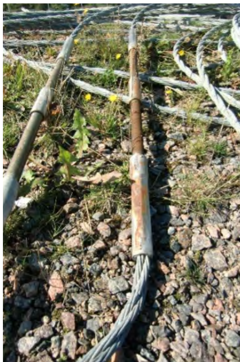
Bild 18. Rostiga presshylsor, vantskruvar och skarvhylsor innebär ökad risk för brott.
