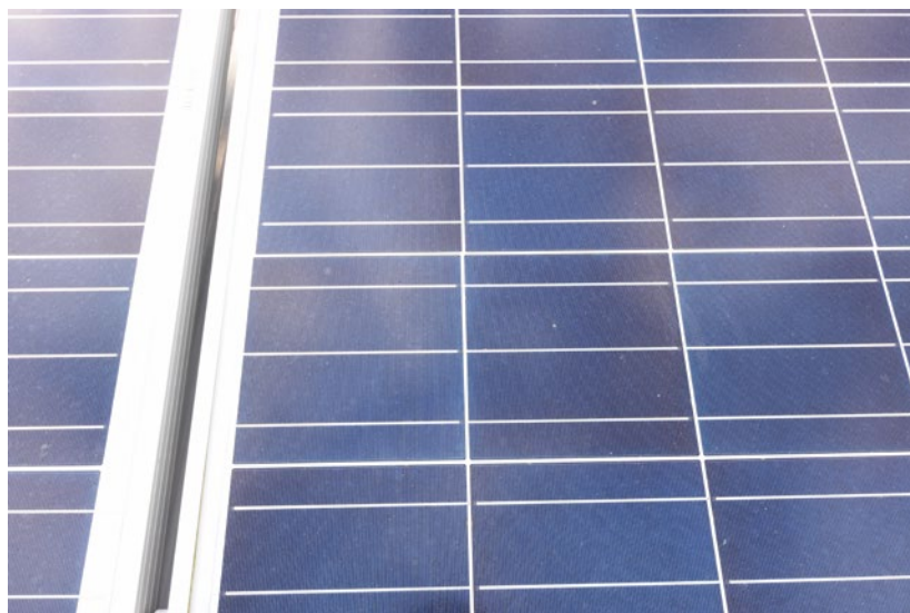
Solcellsmoduler där man ser delar av ramen.
