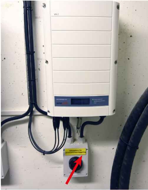
Kablarna från solcellerna är ofta utformade som enledare. De fyra kablar vi ser här är plus och minus till två strängar.
