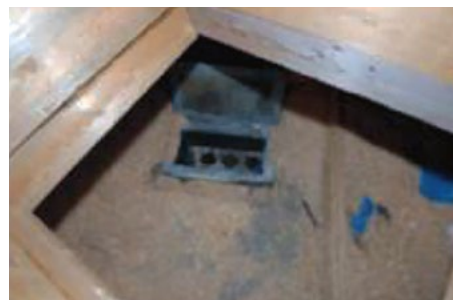
Samlingslåda för ventilation. Rör täckta av sågspån.
