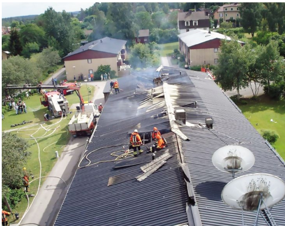
Figur 4. Restvärdesarbete efter branden i Svenljunga. Bilden visar att trots byggnadens längd (över 60 meter) hade skärsläckaren bra effekt på branden. Bild: Krister Palmkvist, SÄRF.
