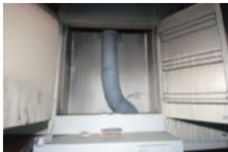
Anslutning från lägenhetens fläkt uppåt till ventilationsrör.
