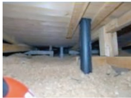
Sågspånsisolering på vind.
