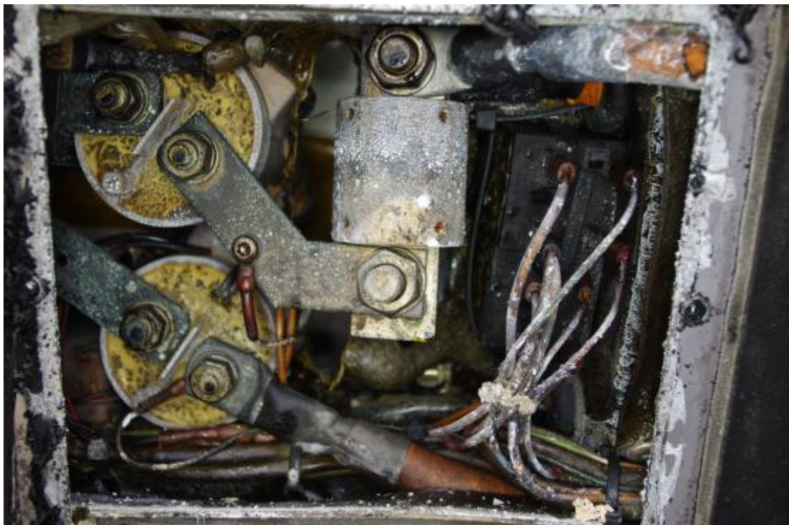
Bild 11 Säkringen var hel och huvudkontakter var funktionsdugliga, vilket visar att extern kortslutning inte förekommit utanför batteriet.
