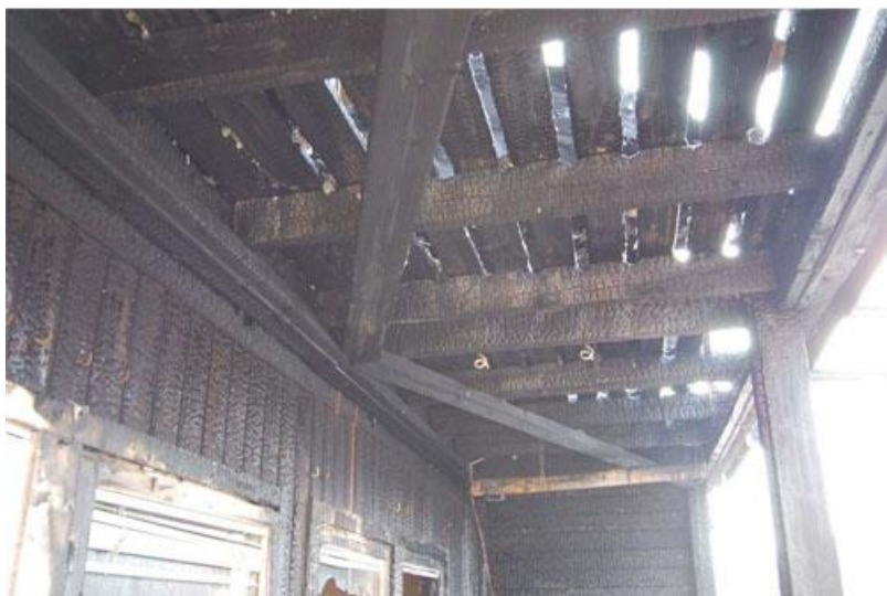
Bild 4. Bilden visar brandskador på balkongen på andra våningen på M-vägen 82.
