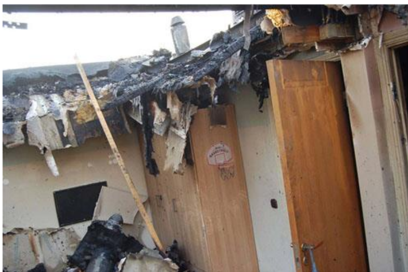
Bild 4. Bilden visar brandskador på tredje vången på M-vägen 82.
