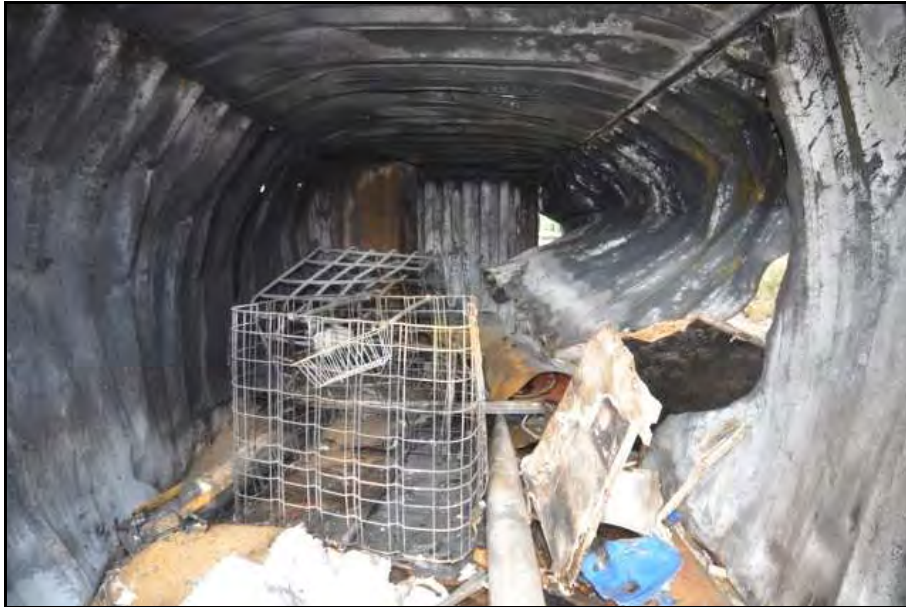
Bild 5: Den nedre tillverkningscontainern sedd från den öppna kortsidan. Det är tydligt att väggplåten bågnar utåt, och den högra långsidan har slitits upp i nederkant och sedan tryckts tillbaka in i containern igen. Endast stålramarna av de två IBC:er som fanns i containern återstår (B och C i Figur 3).
