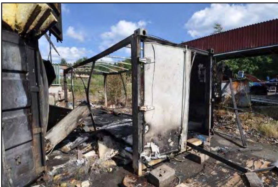
Bild 6: Den i stort sett helt uppbrunna förrådscontainern.
