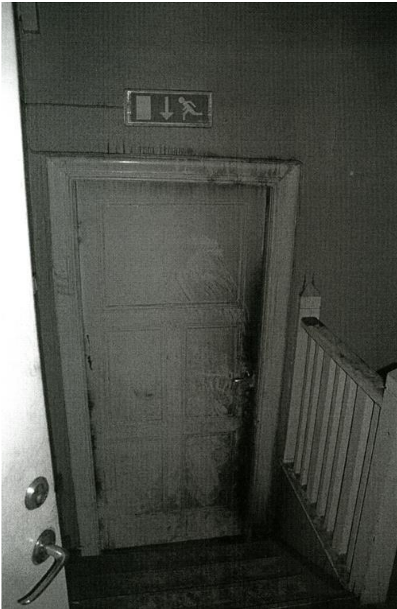
Bilden visar inläckning av rök och sot vid dörren till trapphuset från plan 4.
