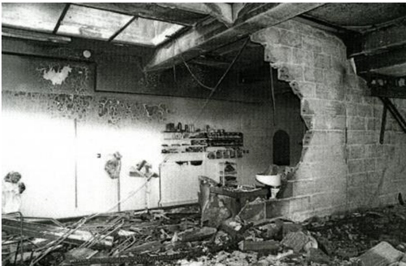
Skador mot grannen, frisörsalongen
