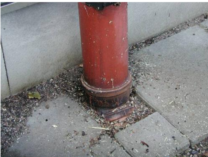
Brännskador på plaströr intill vägg klädd med panel.
