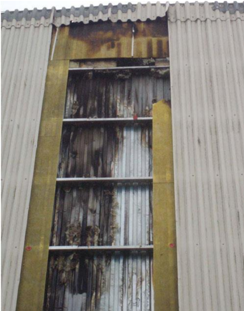
Bild 3: Brandskadad inneplåt i yttervägg
