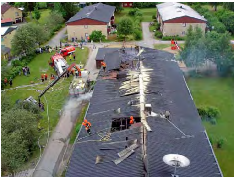
Bild 2 Överblick av brandplatsen.
