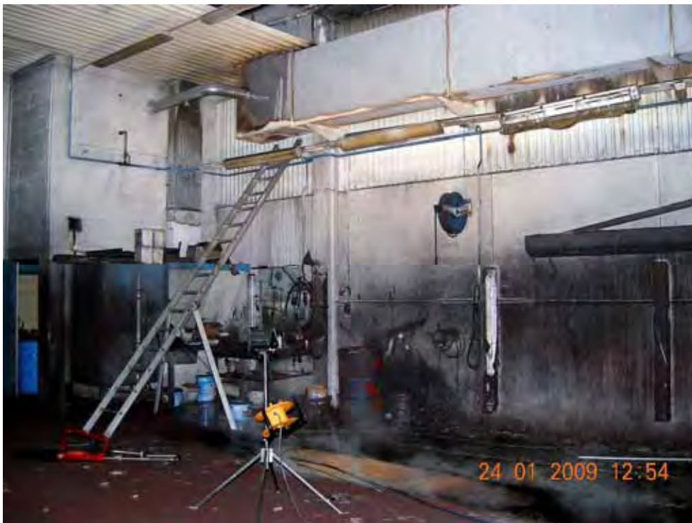
Bild 4 Visar den brandutsatta lokalen. I överkanten av bilden syns den ventilationskanal ditt branden spred sig.
