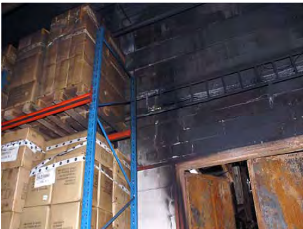
Bild 12 visar tydligt på väggen ovanför dörren kraftig rökspridning in i lokalen ägt rum
